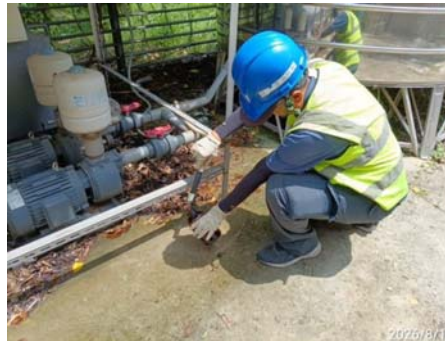
(中水貯留設施)
