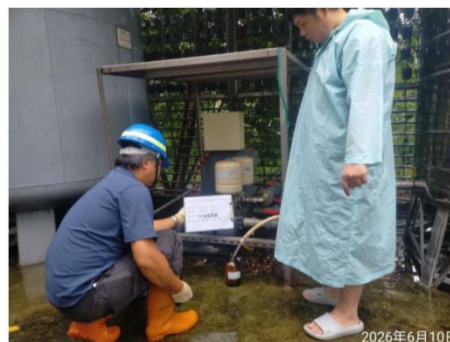
(中水貯留設施)
