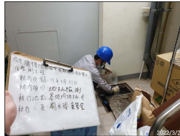
(基地內地下水井)
