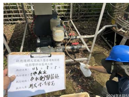
(中水貯留設施)
