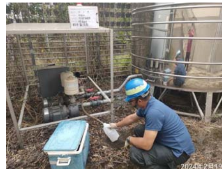
(中水貯留設施)
