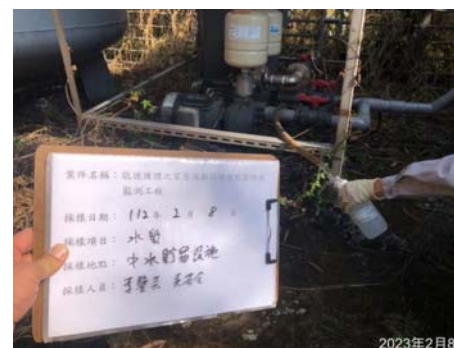
(中水貯留設施)
