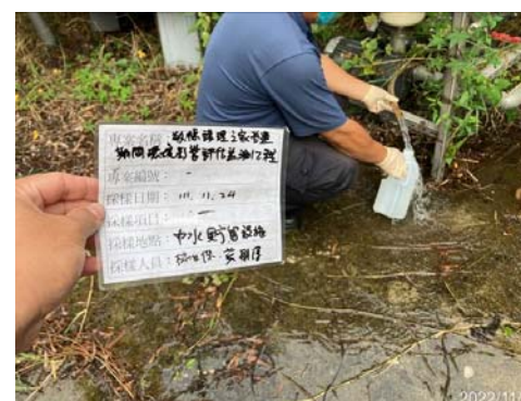
(中水貯留設施)
