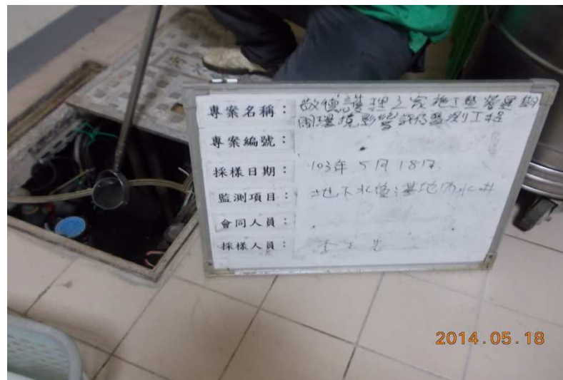
(基地內地下水井)
